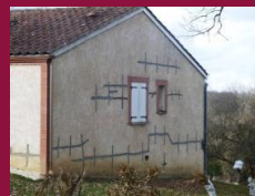
Maison fissurée à Sainte-Foy-de-Peyrolières
